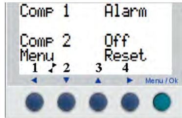
Рисунок 1. Компрессор 1 – авария, Компрессор 2 – выключен.
